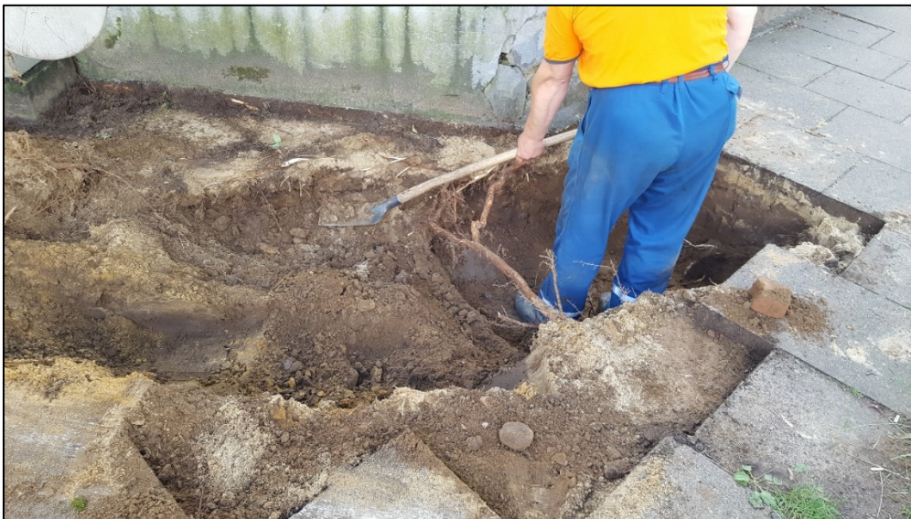
Abbildung 9: Auf der Aufnahme kann man deutlich erkennen, dass Wurzeln zum Teil direkt unter den Gehwegplatten wachsen. Hier ist die Gefahr einer Wurzelverletzung - auch durch Schaufeleinsatz - besonders hoch. Aufnahme: M. Katzer, Baumpflege Bollmann GmbH
