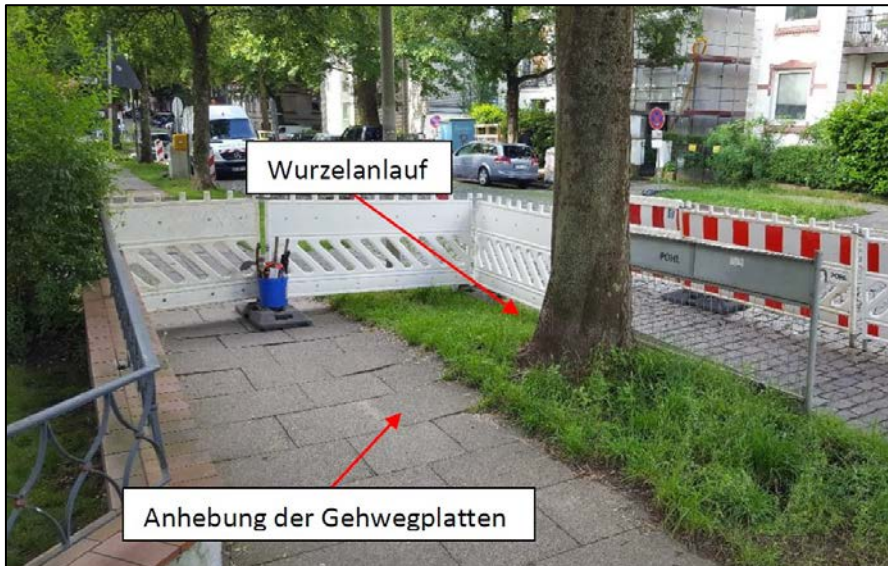
Abbildung 7: Die Ausrichtung der Wurzelanläufe sowie angehobene Gehwegplatten sind häufig sehr gute Indikatoren für das Vorhandensein bodennaher Wurzeln. Hier ist bereits beim Aufnehmen der Platten äußerste Vorsicht geboten. Foto: M. Katzer, Baumpflege Bollmann GmbH
